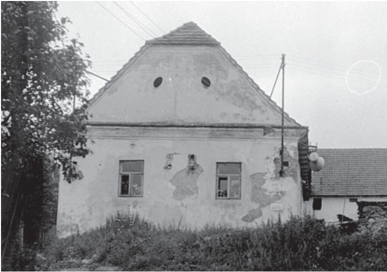
Průčelí statku původního nájemce, kde jsou patrné stopy po vyrvání pamětní desky R. Strimpla ze zdi.
