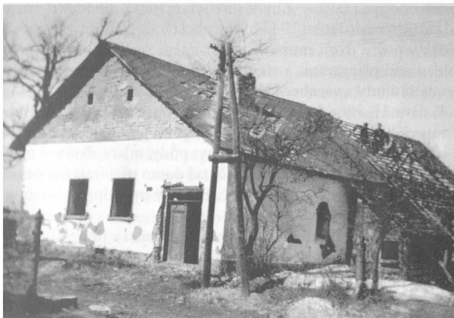
Obr. č. 1: Válkou poškozený dům
